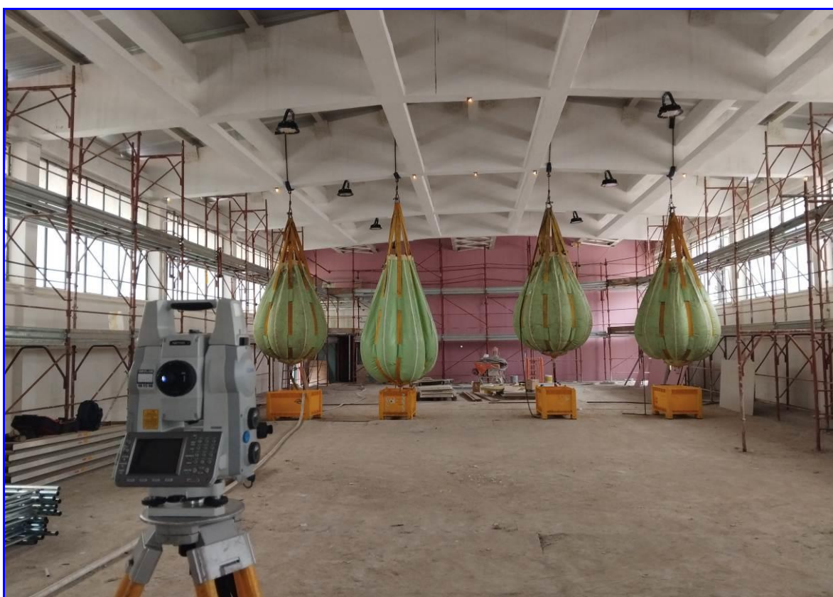
Sacconi di carico (al 100%), stazione topografica e prismi di lettura deformati
